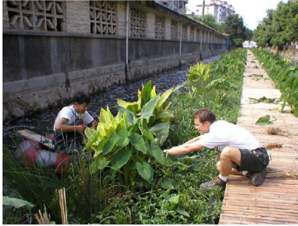
Baima Kanal Bitkisel Atık Su Arıtma Sistemi, Fuzhou, Çin
